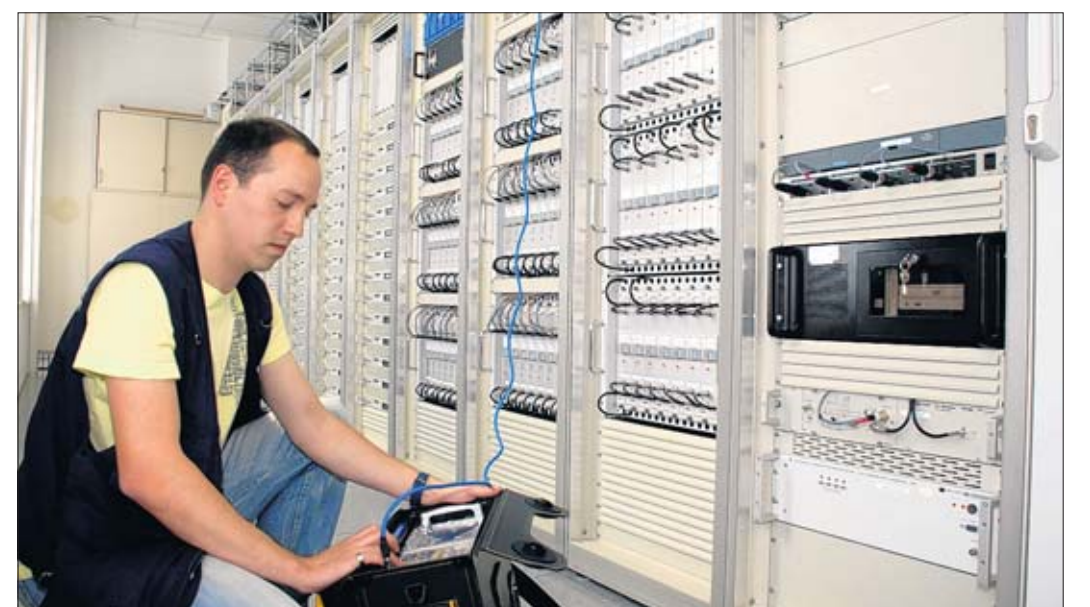
Marcel Minkus, Service-Techniker beim Magdeburger Kabelfernsehanbieter MDCC, überprüft im Schaltraum TV-Signale, die vom Satelliten Eutelsat eingefangen und weiterverteilt werden. Foto: Oliver Schlicht
